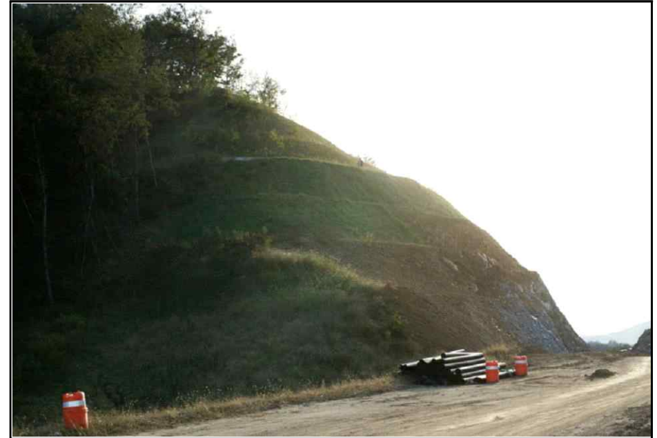
【그림 4】 깎기 비탈면 종점부 측면 사진
